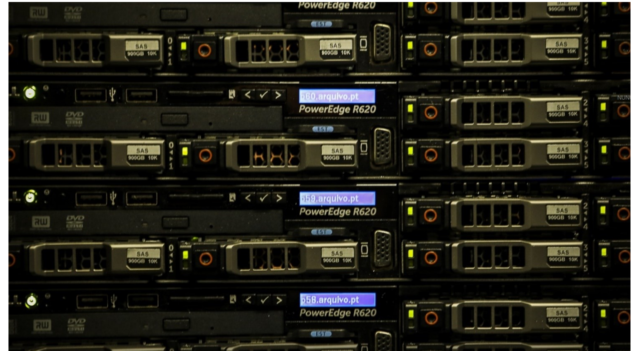
Sala Grid – Unidade FCCN -FCT (pormenor)
