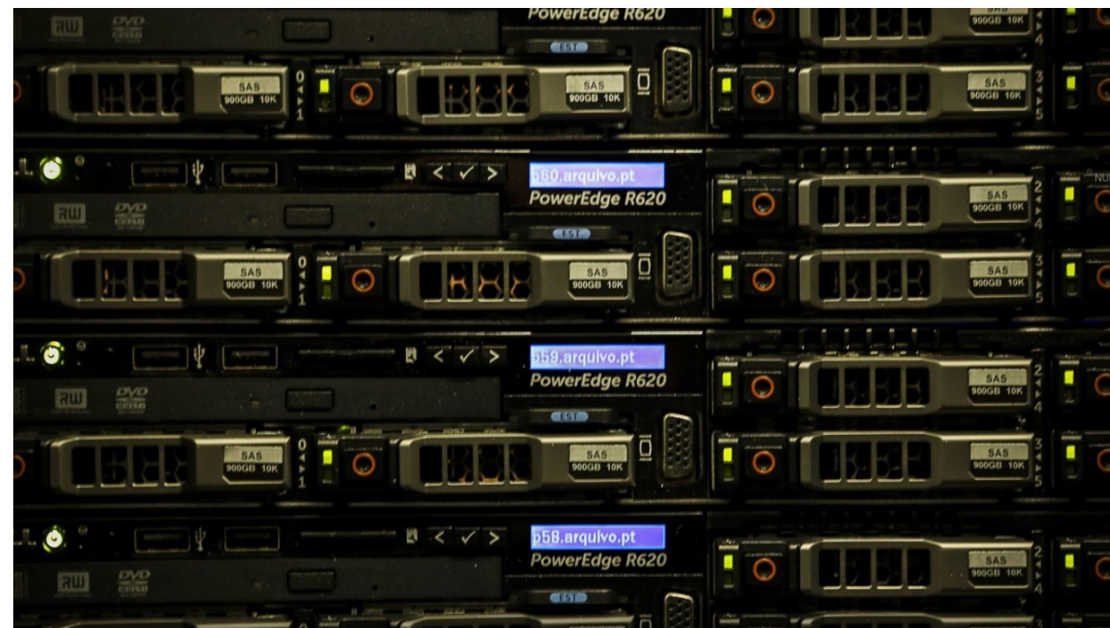
Sala Grid – Unidade FCCN -FCT (pormenor)
