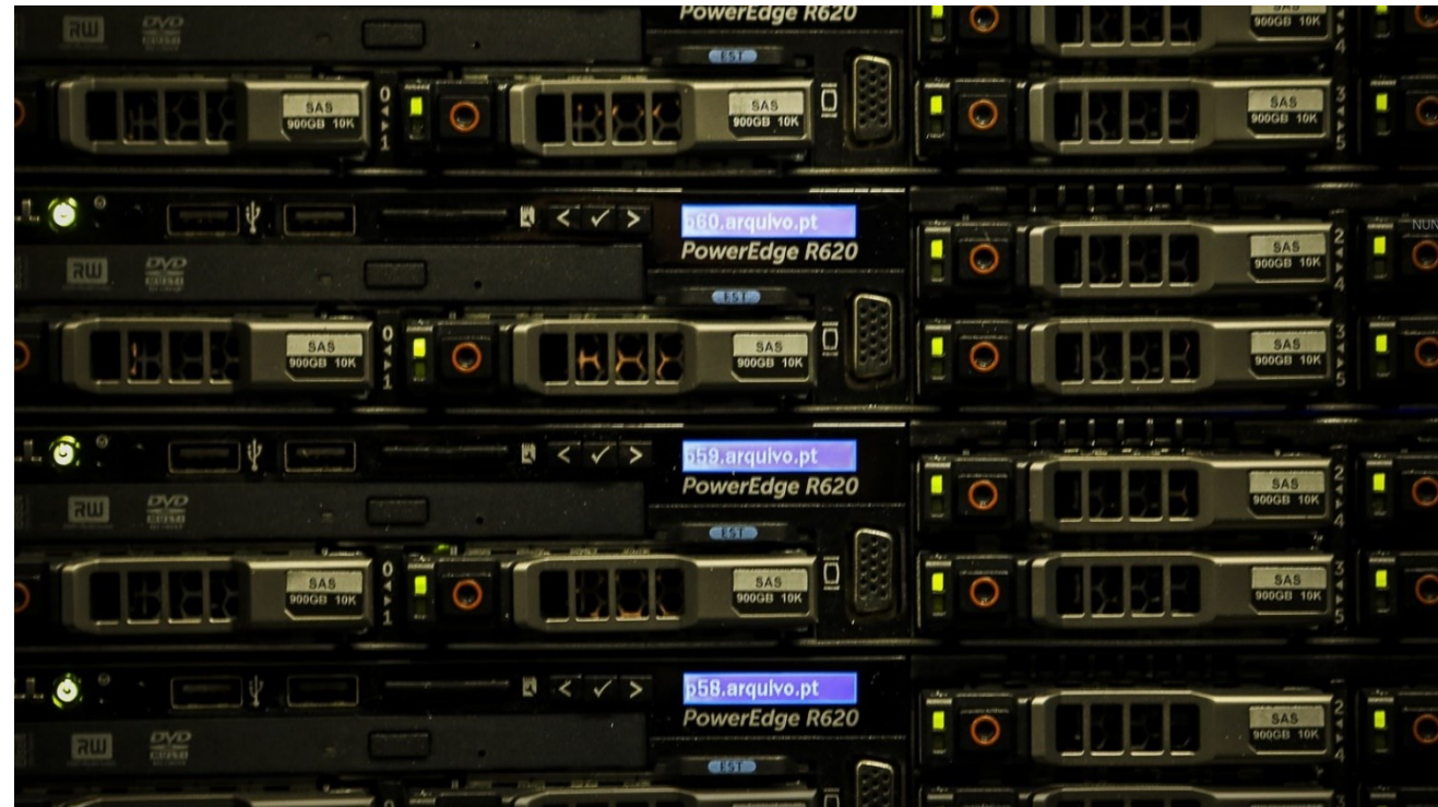
Sala Grid – Unidade FCCN -FCT (pormenor)
